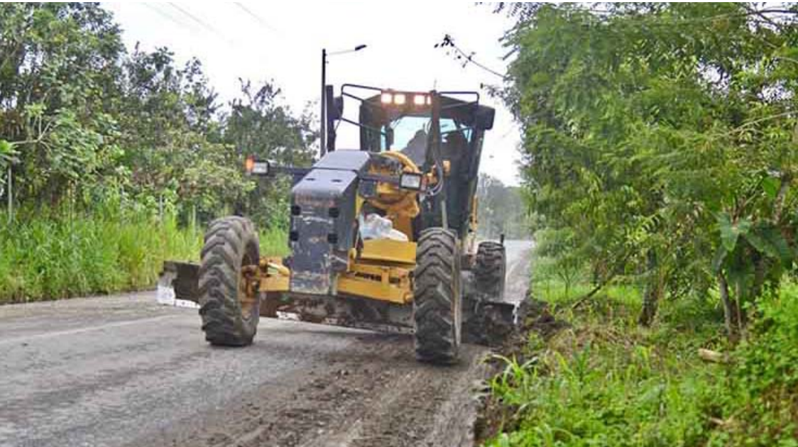
VIALIDAD. Muchas redes estatales que cruzan por Santo Domingo de los Tsáchilas necesitan mantenimiento.
